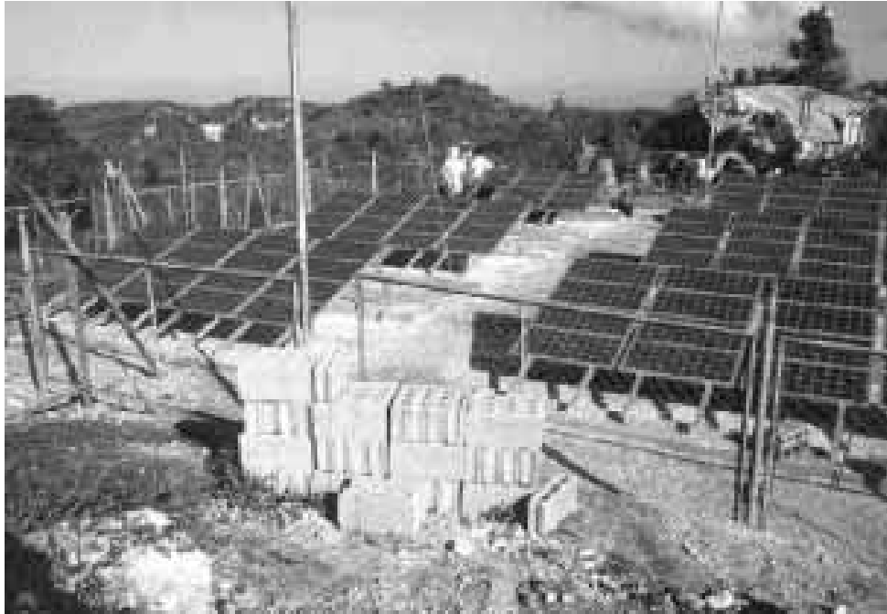
Abb. 50: PVPS zur Trinkwasserversorgung auf den Philippinen
